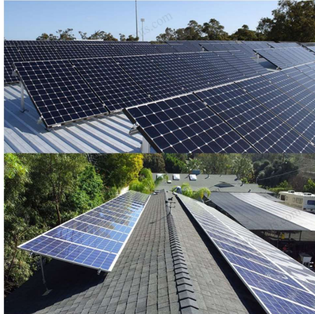
Ilustración 21. Ejemplo de estructura solar. [Fuente: Solar Parts Components]
