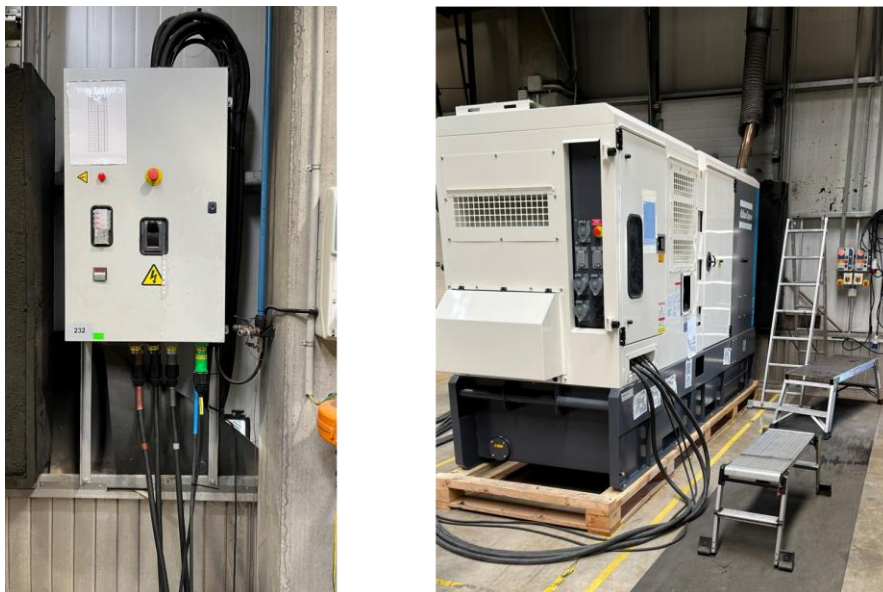
Figura 5 - Conexión del banco de carga al grupo para la prueba
