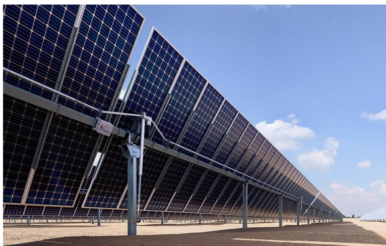
Ilustración 5.2: Ejemplo de paneles solares instalados en un seguidor solar [27].
