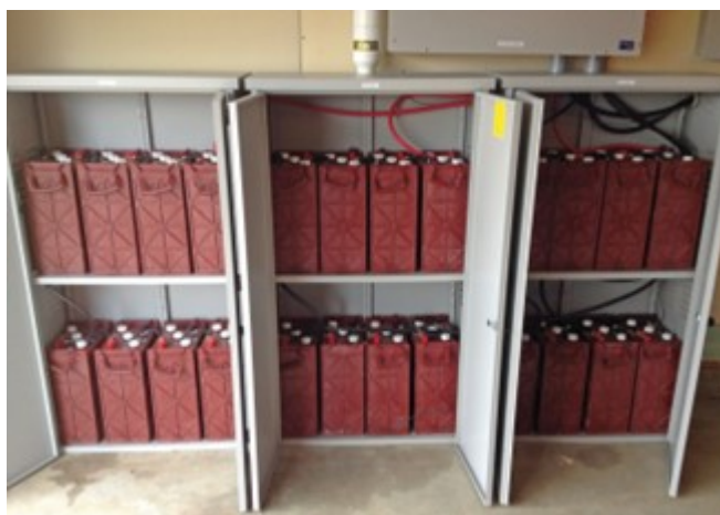
Ilustración 3.2: Banco de baterías de instalación solar [11]
