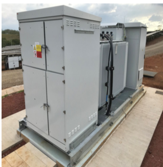
(b) Inversor sobre hormig3n [13]
