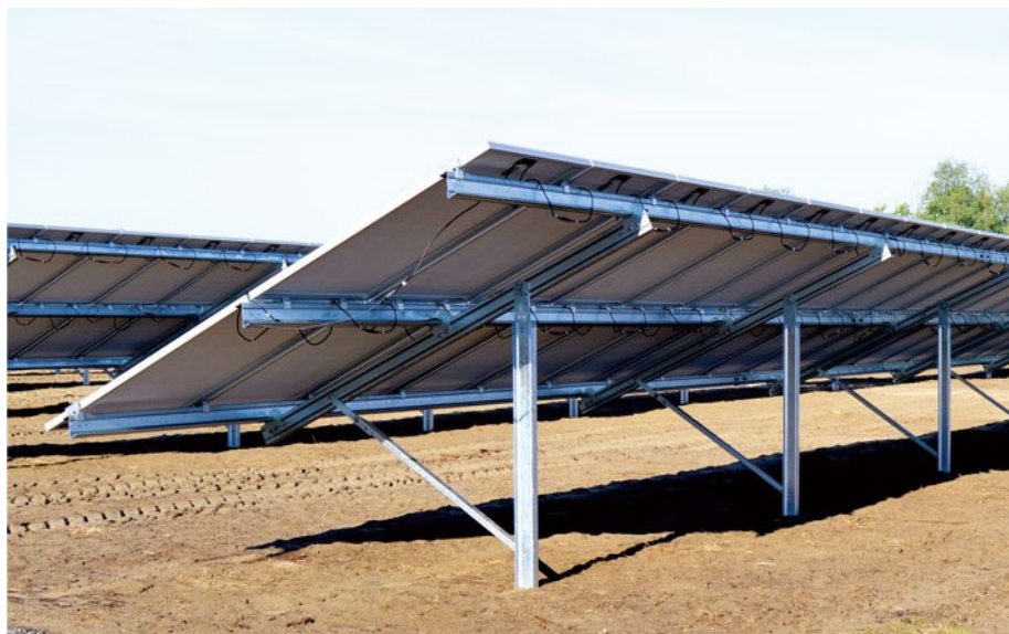
Ilustración 5.3: Ejemplo de paneles solares instalados en una estructura fija [29].
