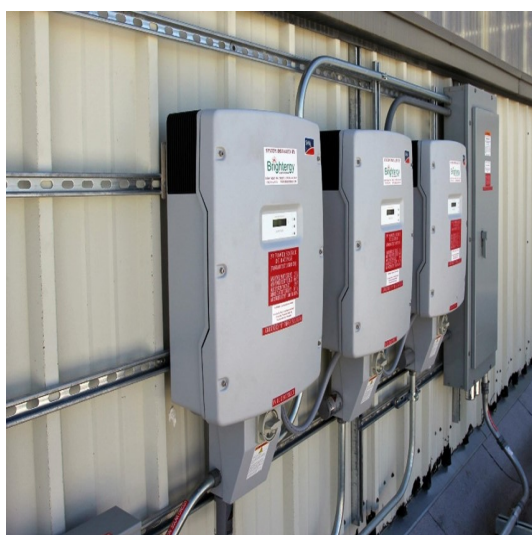
(a) Inversores de instalaci3n solar [12].
