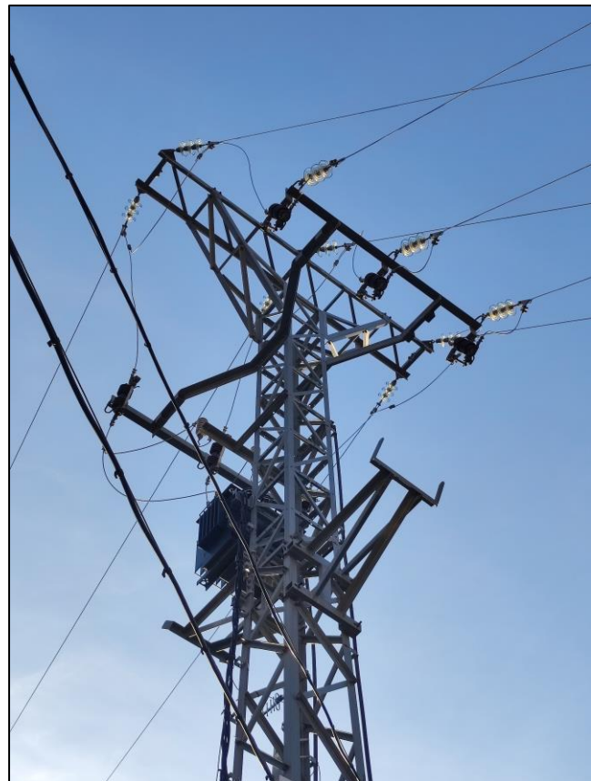
Fig. 36: Apoyo 31, conexión a central hidráulica
