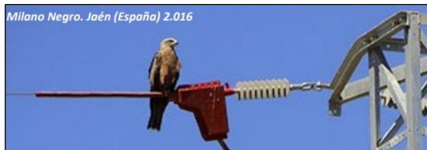
Fig. 14: Aislamiento cadenas de amarre
