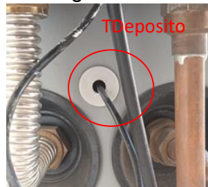
FIGURA 35: Imagen de la sonda TDeposito.
