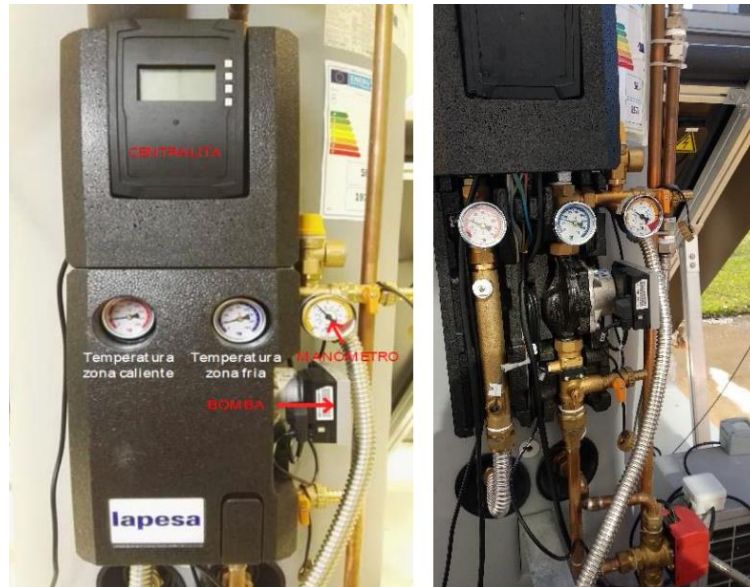
Figura 29: Imagen del grupo de bombeo utilizado [21].
