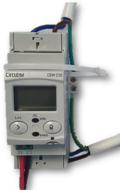
Figura A.5: Contador de energía
