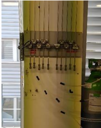
Figura 5. Líneas de tuberías que llevan los gases desde la alimentación hasta los controladores de caudal
