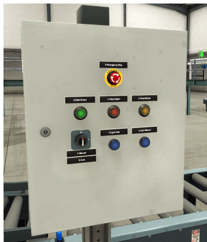
Figura 11. Panel de control de cualquier estación de la planta.
