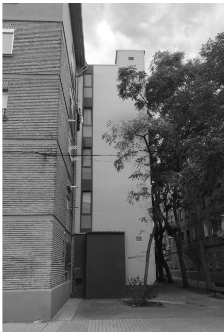
Figura 2.43: Fachada posterior. Cuarto de contadores.
