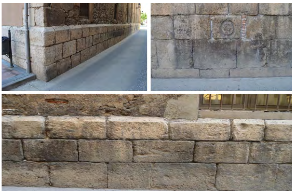
Fig. 15. Colegio de los Jesuitas de Nuestra Señora del Pilar, actual sede de la UNED (Lateral de la c/ José Llanas). Se aprecian los grandes sillares procedentes del foro de Bilbilis empleados en la cimentación y zócalo del edificio (Fotos: Carlos Sáenz).
