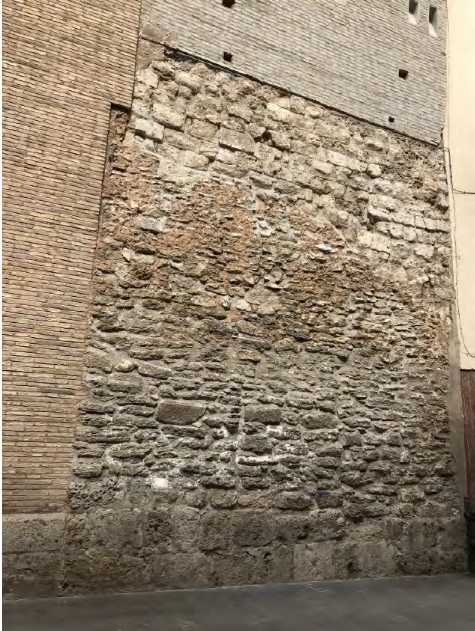
Fig. 11. Tramo inferior de la torre de San Pedro de los Francos. Se aprecian los sillares de caliza procedentes de edificaciones bilbilitanas (Foto: Archivo del CEB)
