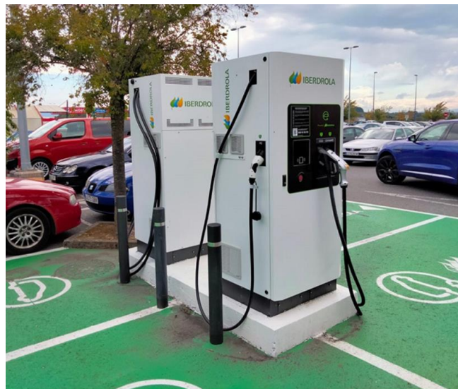
Fotografía 1: estación de carga con 4 cargadores. Fuente: Iberdrola.
