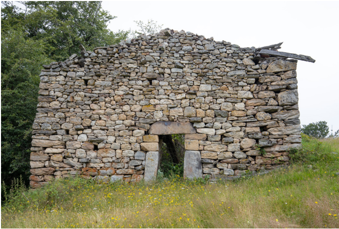
Fig. 30. Ejemplo de mampostería irregular en un invernial en ruinas. (Autor, 2023)
