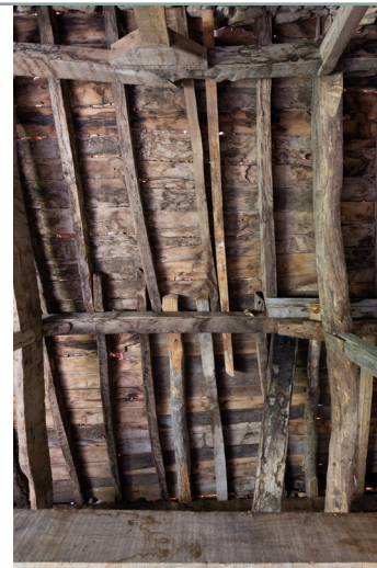
Fig. 114. Imagen del estado actual de la cubierta donde se muestran los cabrios apoyándose en las vigas forasteras y las tercias. (Autor, 2023).
