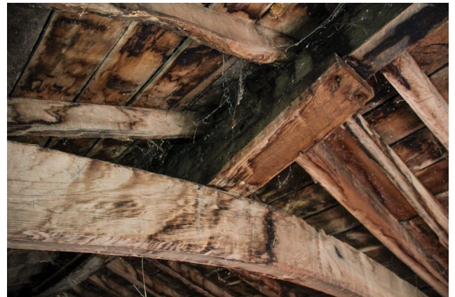
Fig. 75. Imagen de detalle de la estructura de la cubierta donde se observa la disposición de un enano sobre el caballo para dar soporte al cumbrial. (Autor, 2023)
