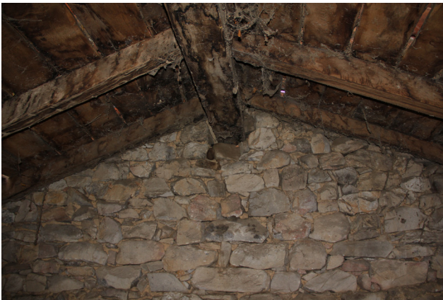
Fig. 95. Ejemplo del encastramiento del cumbrinal en la mampostería, encargándose en este curioso caso de soportar el peso de la cubierta. (Autor, 2023).
