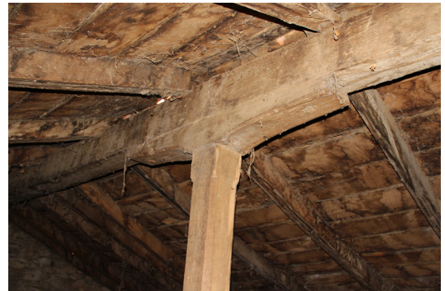
Fig. 96. Detalle del encuentro entre el cumbrinal y el pie derecho. Se aprecia la unión en forma de rayo de Jupiter de las dos vigas que conforman el cumbrinal bajo la que se sitúa una zapata para distribuir la carga hacia el pilar central de madera. (Autor, 2023).
