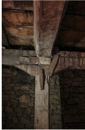
Fig. 72. Unión de tres vigas apoyadas sobre la zapata y el pie derecho. Se observan varios trozos de madera que sirven para reforzar la unión. (Autor, 2023)
