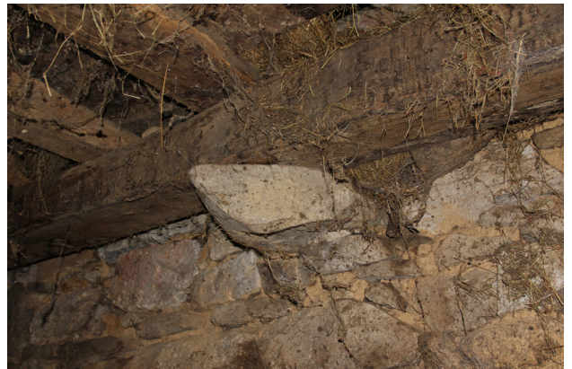
Fig. 100. Detalle poco habitual de como una piedra a modo de traba de la mampostería sobresale para recoger la viga de soporte del forjado del pajar. (Autor, 2023).
