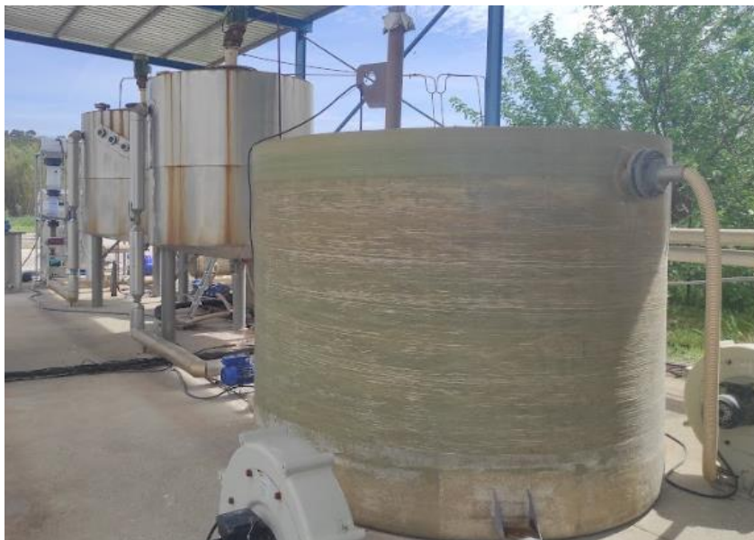
Figura 5: Planta piloto de digestión anaerobia de fangos (EDAR Tudela).
