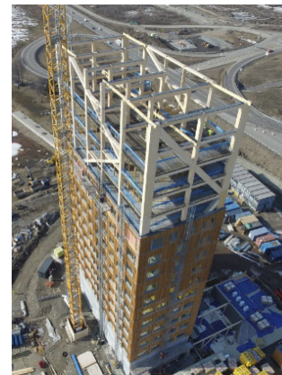
Fig. 119. Imagen fase construcción 3. Estructura, forjados y fachadas. CLT, GLT, VLV y hormigón.
