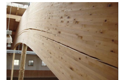
Fig. 32. Viga de madera con fisuras generadas por un exceso de cargas.
