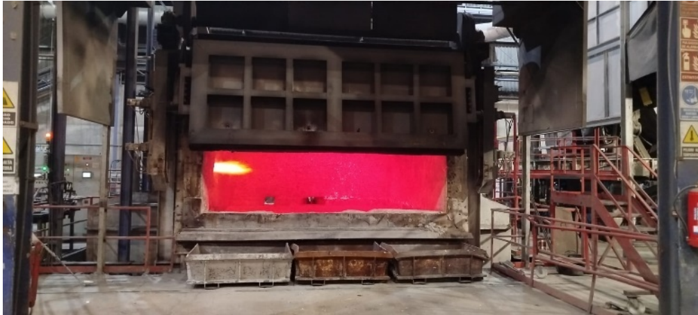
Figura 22. Horno de mantenimiento
