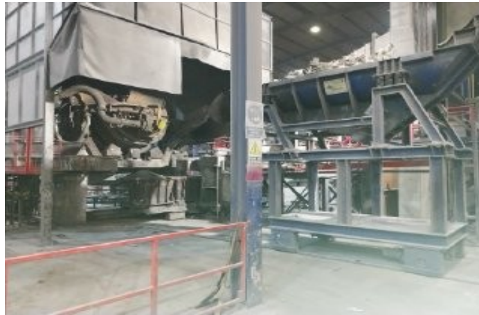
Figura 19. Proceso de carga del HRB
