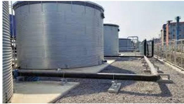
Ilustración 20: Depósito de agua [38]
