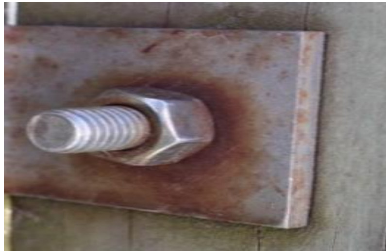
Figura 3. Ejemplo de corrosión galvánica. Fuente: patologíasconstruccion.es
