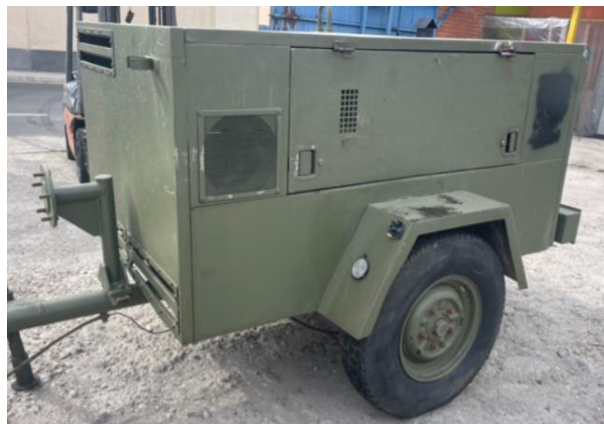
Figura 11. Grupo electrógeno 12 kVAs (elaboración propia)
