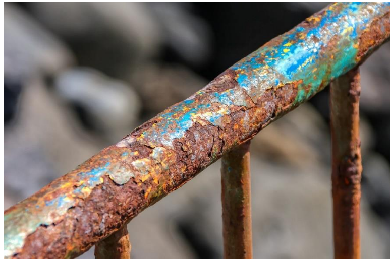
Figura 1. Ejemplo de corrosión atmosférica. Fuente: issuu.com
