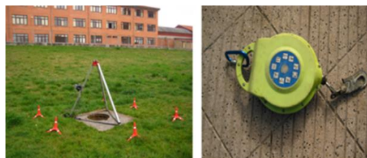
Ilustración 23. Montaje de un trípode sobre un pozo registro y anti-caídas. Fuente: U.E.S.
