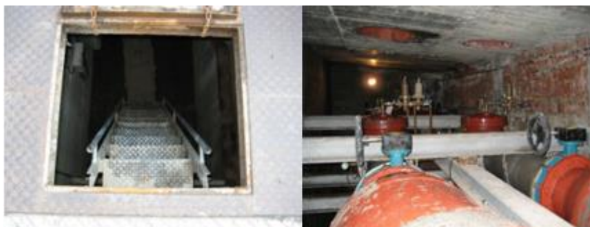
Ilustración 57. Entrada e interior de un habitáculo de agua potable. Fuente: U.E.S.
