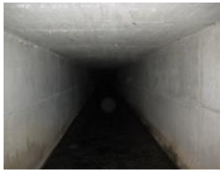
Ilustración 54. Colector con hastiales y bóveda de obra de hormigón prefabricado. Fuente: U.E.S.
