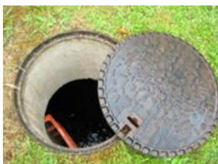
Ilustración 58. Entrada a un pozo de registro con su tapa de cierre. Fuente: U.E.S.
