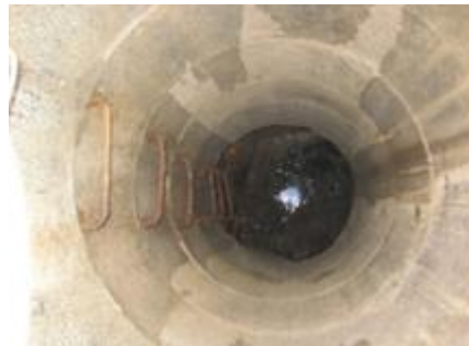
Ilustración 60. Bajada de pozo de registro con pates de hierro. Fuente: U.E.S.
