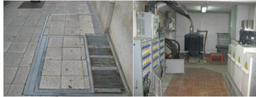
Ilustración 21. Entrada e interior de un habitáculo de un transformador eléctrico. Fuente: U.E.S.
