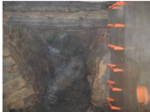
Ilustración 59. Bajada de pozo de registro con pates de PVC. Fuente: U.E.S.
