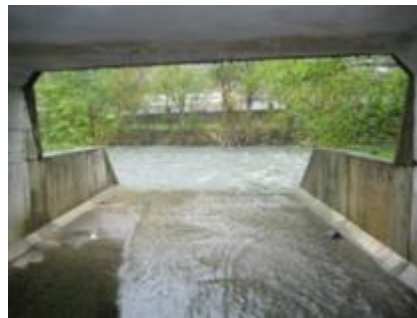
Ilustración 48. Cola de colector vertiendo a río. Fuente: U.E.S.
