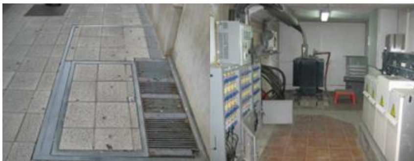
Ilustración 56. Entrada e interior de un habitáculo de un transformador eléctrico. Fuente: U.E.S.
