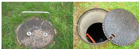
Ilustración 24. Entrada a pozo de registro con su etapa de cierre. Fuente: realizada por el autor.
