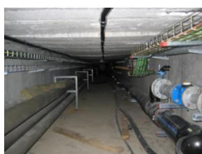
Ilustración 20. Galería de varios servicios. Fuente: U.E.S.
