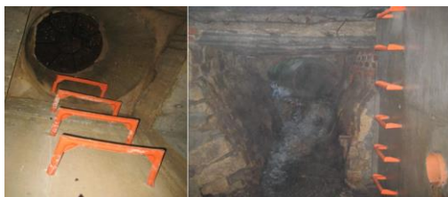
Ilustración 25. Bajada de pozo de registro con pates 9 de PVC. Fuente: realizada por el autor.
