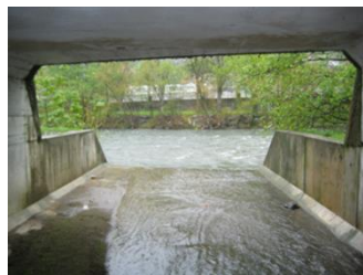
Ilustración 18. Cola de colector vertiendo a río. Fuente: realizada por el autor.
