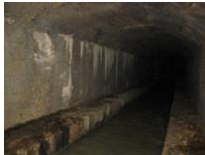
Ilustración 51. Colector de aguas residuales con cuna y dos andenes. Fuente: U.E.S.
