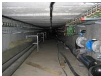
Ilustración 55. Galería de varios servicios. Fuente: U.E.S.
