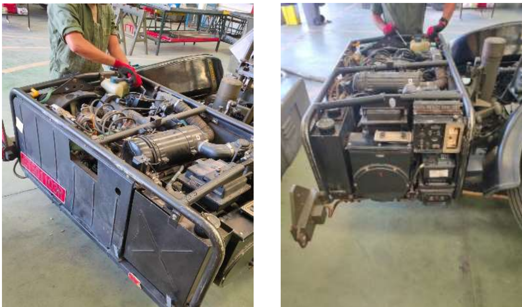
Ilustración 3 : Grupo electrógeno (fuente: propia)
