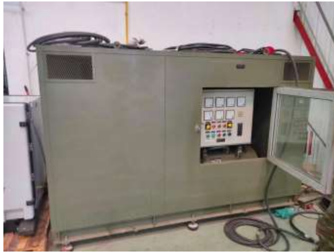
Ilustración 8 : Vista general del convertidor (fuente: propia)
