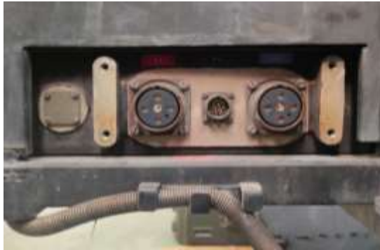
Ilustración 6 : Entrada de conexiones entre grupo electrógeno y el Sistema de Armas 35/90 (fuente: propia)
