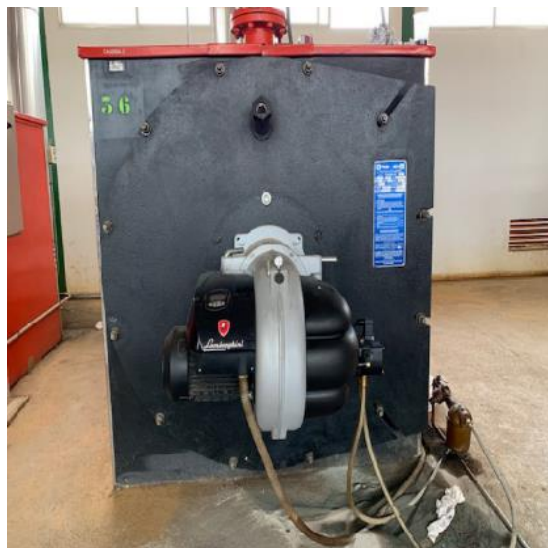
Ilustración 9. Caldera ACC 2. Fuente: elaboración propia
