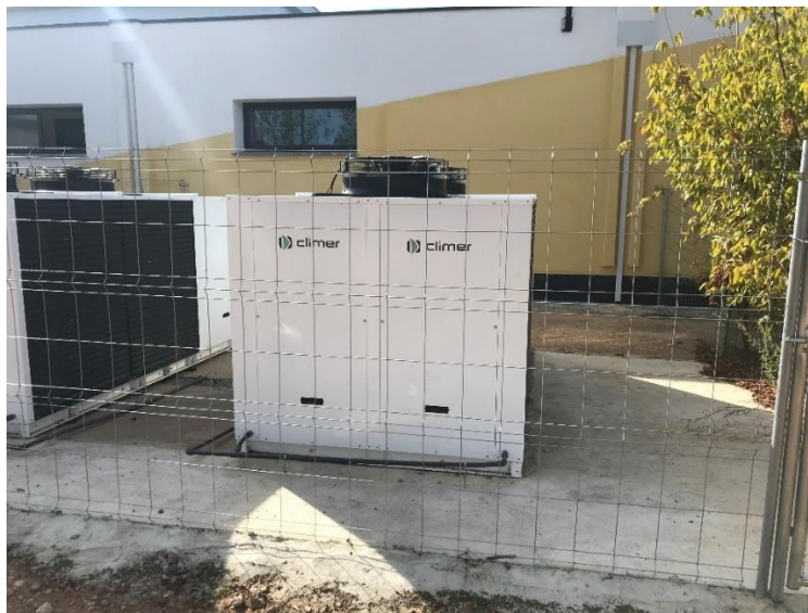
Ilustración 12. Equipos de aerothermia. Fuente: elaboración propia
