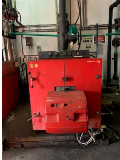
Ilustración 11. Caldera ACS 2. Fuente: elaboración propia
