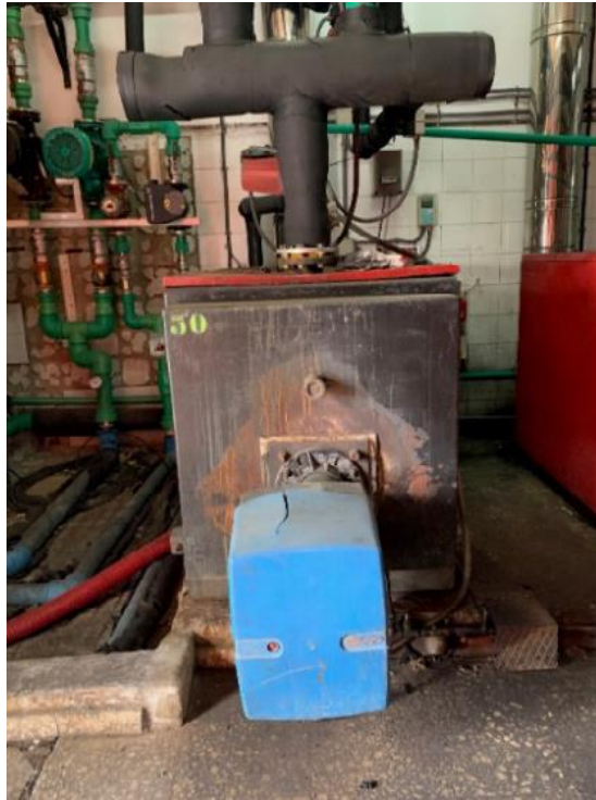
Ilustración 8. Caldera ACC 1. Fuente: elaboración propia
