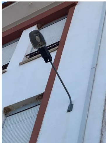
Ilustración 6. Luminaria exterior sobre soporte de pared, bombilla de vapor de mercurio de alta presión. Fuente: elaboración propia
