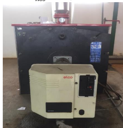
Ilustración 10. Caldera ACS1. Fuente: elaboración propia
