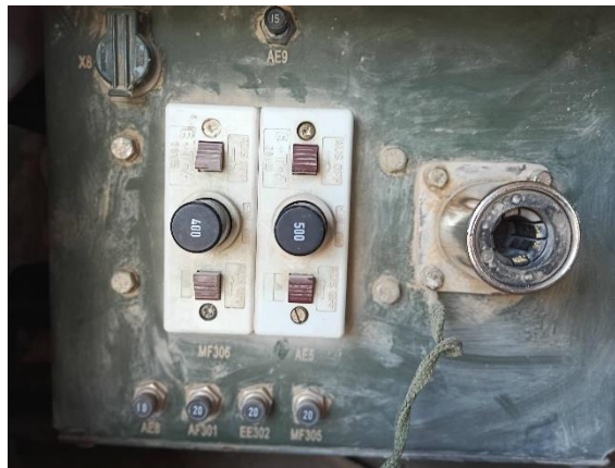
Figura 15. Entrada de la toma de cable esclavo. Fuente: Elaboración propia.
