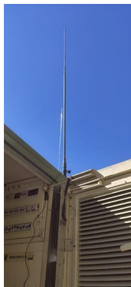
Figura 16: Vista completa de ambas antenas
