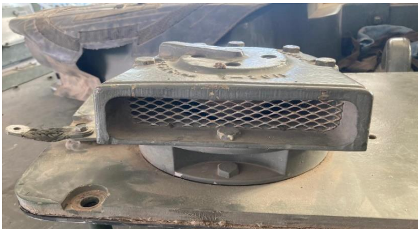
Figura 3. Sistema de ventilación de la EWNA. Fuente: Elaboración propia.
