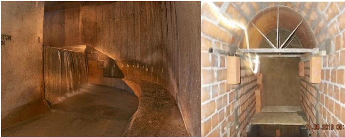
Figura 28. Alcantarilla de la red de saneamiento de Madrid. (Rodríguez, 2019) (Retema, 2016)
