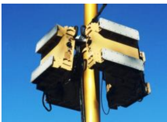
Figura 6. AUDES. Sistema de detección. Radar (Gallego, 2020).
