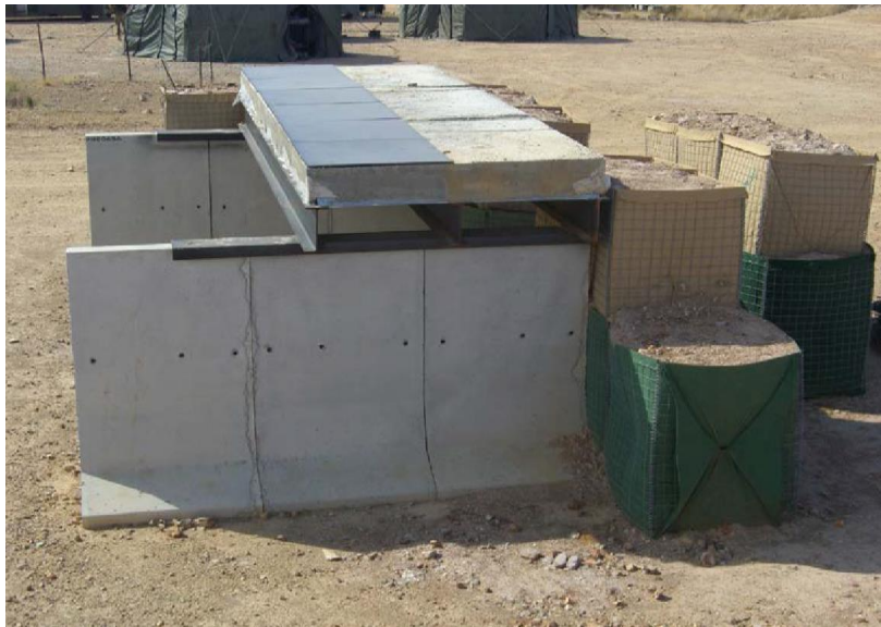
Imagen 32, estructura en base a la combinación de T-Wall y Hescos. Fuente: Tte. Coll Mora.
