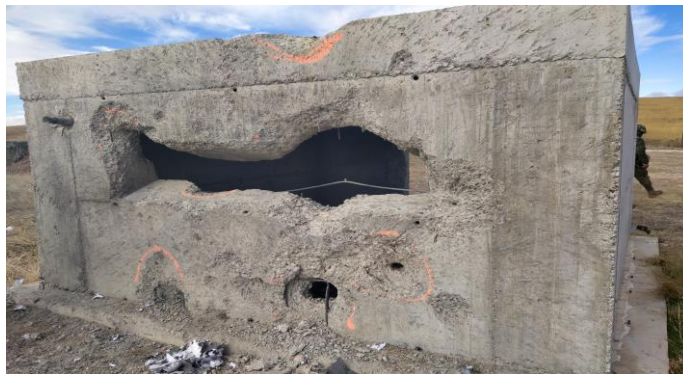
Imagen 23, Bunker después del impacto.
