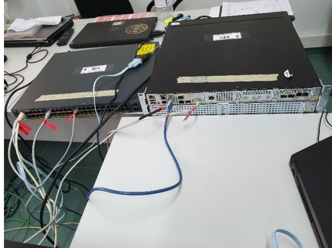
Figura 29 Router IPC2 y switch de terminales satélite
