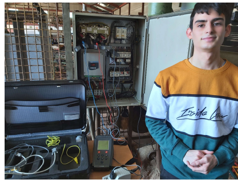
Figura 7. El estudiante, al lado del circuito trifásico de suministro de la galera.
