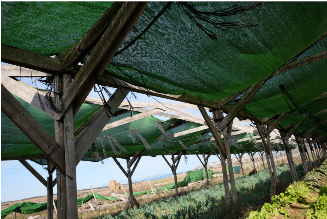
Figura C.2. Detalle de la estructura de sombreado mediante malla instalada en la cubierta del sistema agrivoltaico.
