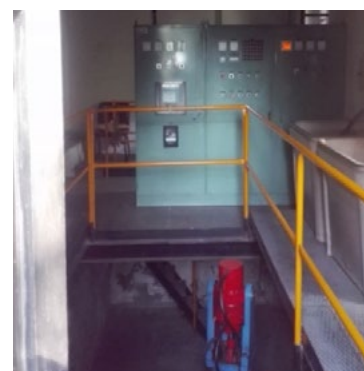
Figura 8 Minicentral al interior de una casa en Amorebieta Echano
