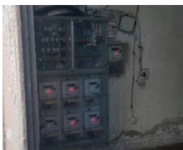
Figura 36 Tablero eléctrico de una casa de Hervás.
