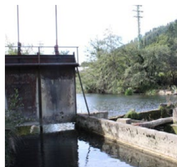
Figura 4 Compuertas de minicentral hidráulica en Balmaseda
