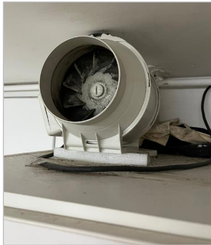
Figura 36. Extractor sótano Montecanal
