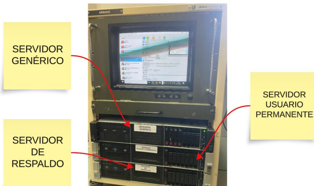
Ilustración 19: Servidor TAK CIATRANS 18 (Fuente: Elaboración propia).
