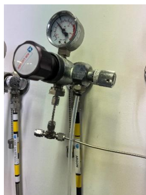
Figura 5. Tubería de argón.
