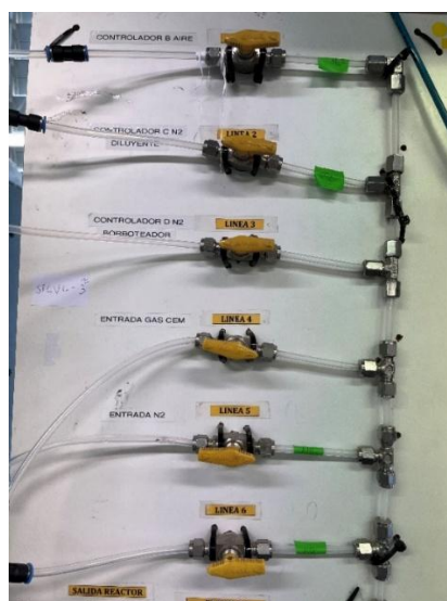
Figura 7. Cuadro de válvulas manuales.
