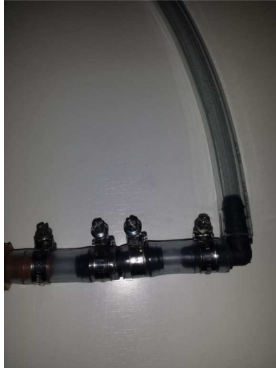
Figura 56: Tubería de descarga. Fuente propia
