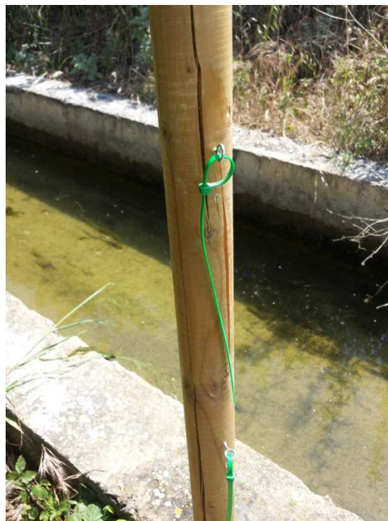
Figura 66: Foto de elemento de fijación de la tubería de descarga. Fuente propia
