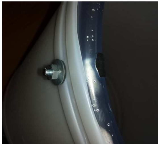
Figura 122: Detalle de la unión de la tubería de 15 mm al tambor. Fuente propia
