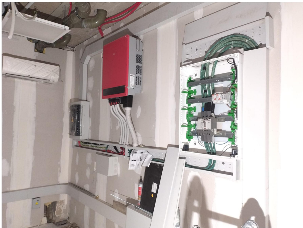
Figura III.10. Inversor edificio multiusos. Fuente: Elaboración propia.
