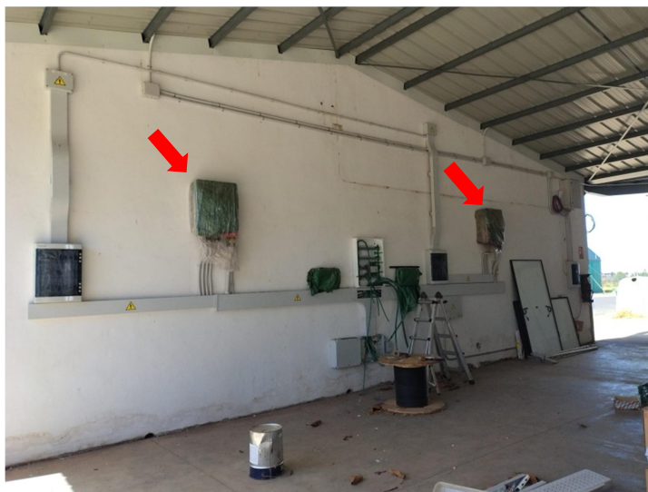
Figura 10. Instalación eléctrica con los inversores del tinglado. Fuente: Elaboración propia.
