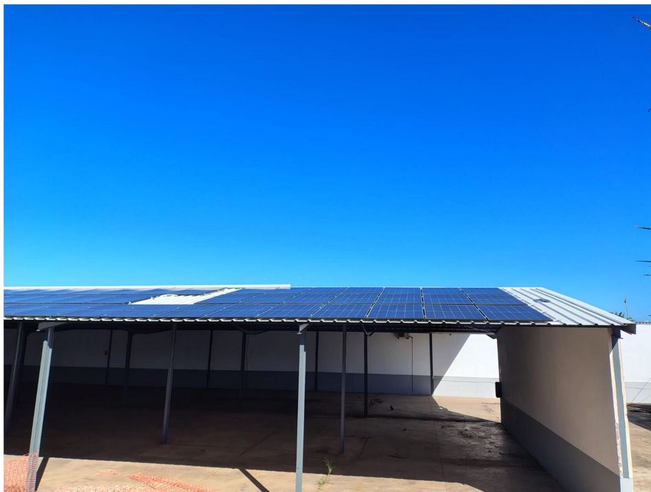
Figura III.1. Paneles fotovoltaicos en el tinglado. Fuente: Elaboración propia.
