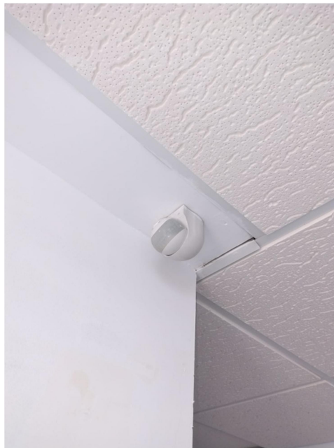
Figura 20 . Detector de presencia autónomo instalado en zona común nuevo edificio multifunción. Fuente: Elaboración propia.
