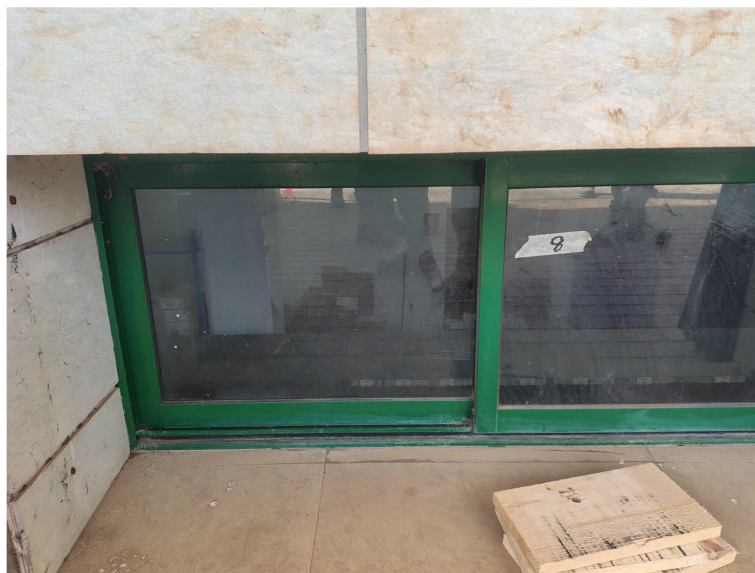
Figura 17. Ventanas edificio alojamiento militar antes de ser cambiadas. Fuente: Elaboración propia.
