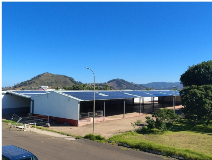
Figura 9. Paneles fotovoltaicos instalados en el tinglado. Fuente: Elaboración propia.
