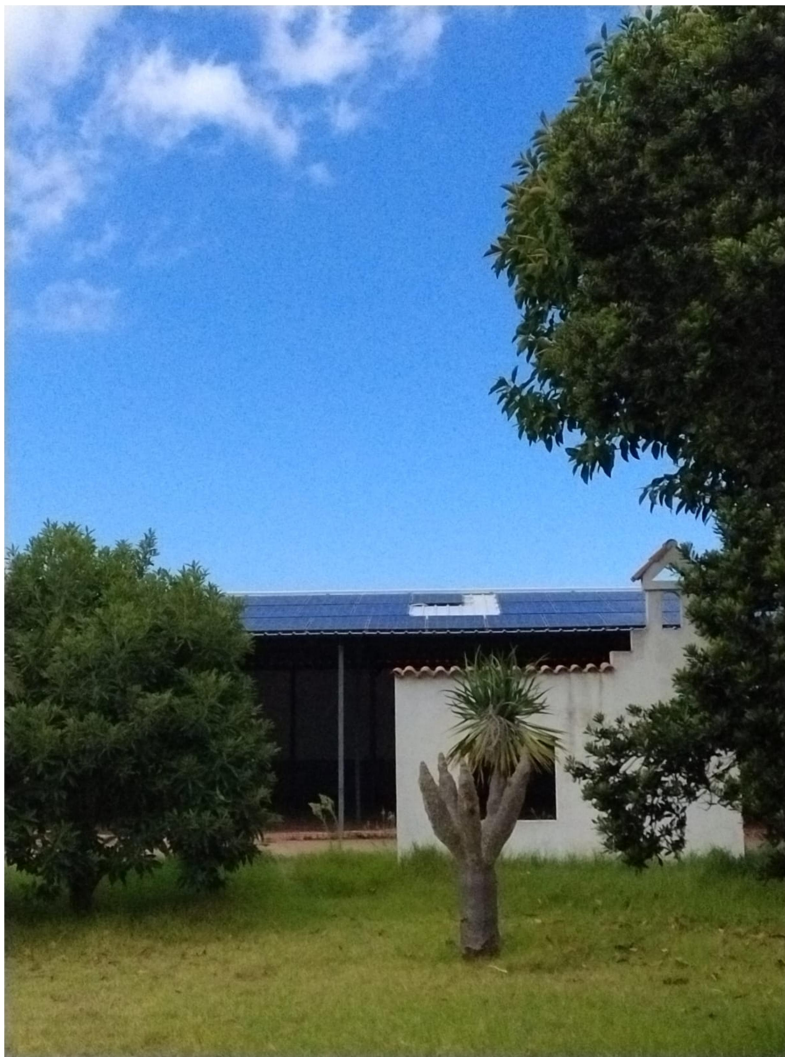
Figura III.3. Diferente vista de paneles fotovoltaicos en el tinglado. Fuente: Elaboración propia.
