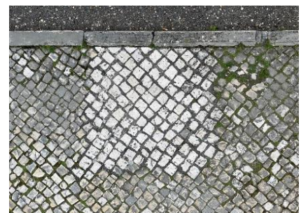
Fig. 65. Antigua reparación del suelo con un tipo de piedra diferente a la original del antiguo suelo.
