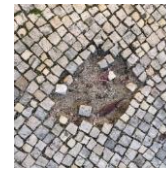
Fig. 52. Desprendimiento piedras en Coimbra.
