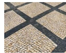
Fig. 64. Aceras desgastadas de Coímbra.
