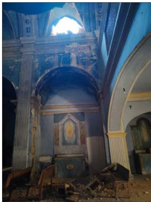
Fig. 5. Último tramo de la nave arruinado en la Iglesia del Convento de Concepcionistas Franciscanas en Las Cuevas de Cañart. Fotografía: Comarca del Maestrazgo, 2023.
