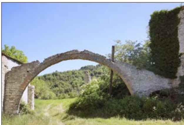
Fig. 5. Restos del arco frontal y de las columnas centrales del aventador de casa Plana de Samitier (Foto: autores).
