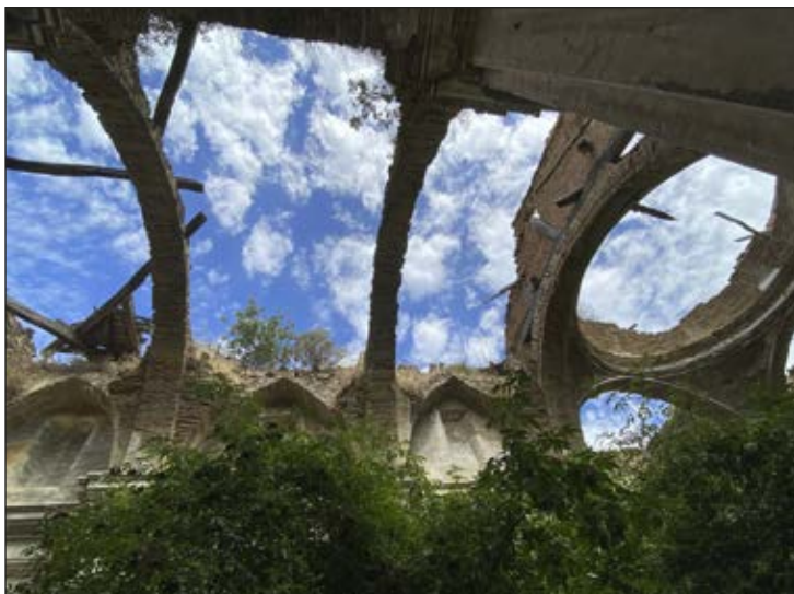
Fig. 6. Tiermas: interior de la iglesia de San Miguel Arcángel. La cubierta se ha desmoronado, arrastrando la estructura encamonada de la cúpula del crucero y de la bóveda que cubría su nave, de la cual solo se mantienen algunos arcos fajones, mientras la maleza lo cubre todo. Foto de la autora.
