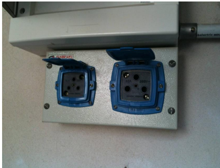
Ejemplo de tomas de corriente trifásicas
