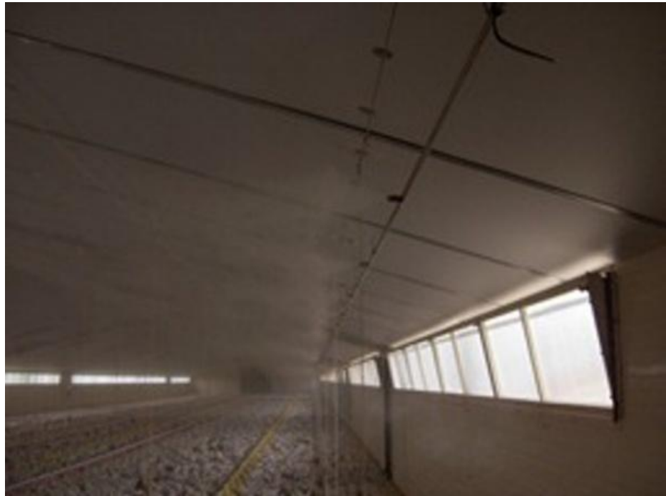
Detalle de boquillas de alta presión nebulizando en nave de pollos de engorde
