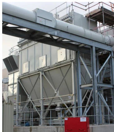
Figura 5. Filtro de mangas con paneles de venteo en el lateral [22]
