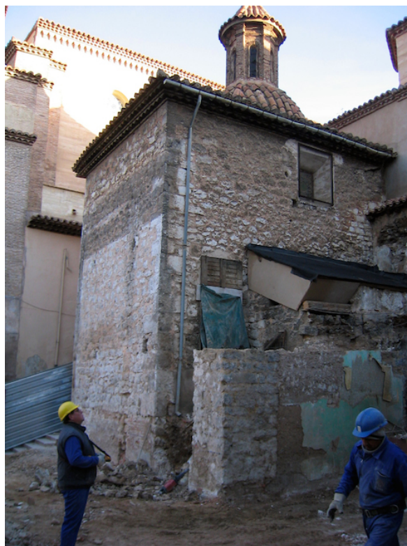
Figura 4.103 – La capilla del mausoleo una vez efectuadas las obras de demolición de la casa sacristana, en diciembre de 2003 (fotografía: Alejandro Cañada)
