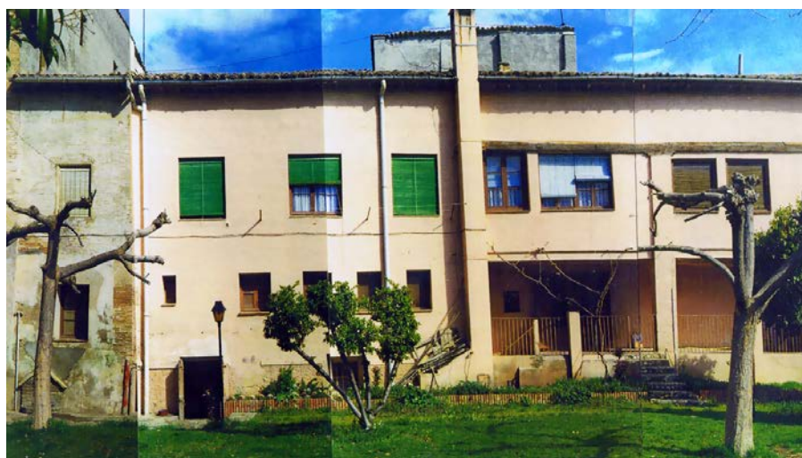
Figura 3.37 – Fachada lateral del palacio episcopal de Barbastro antes de la reforma (fotografía: José Miguel Ferrando)
