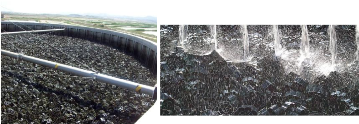
Figura 6. Foto real del proceso de lechos bacterianos. Fuente: Elaboración propia
