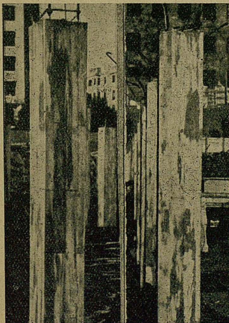
Dos de las columnas de hormigón armado más alteradas por el hongo merulius lacrimans , micelio que existía en la madera del cofre.
