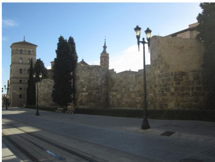
Fig. 23. Perspectiva de la muralla de Zaragoza en el tramo de San Juan de los Panetes. (Foto: del autor).
