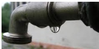
Imagen 12. Fuga de agua 27
