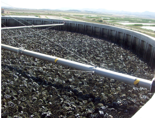
Figura 3.2: Filtros percoladores del reactor biológico.
