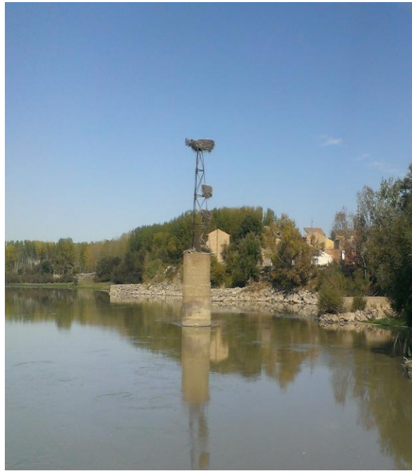
Foto 20 y 21. Pilastras en el cauce del río en Alcalá de Ebro. Autor: Sara Salas
