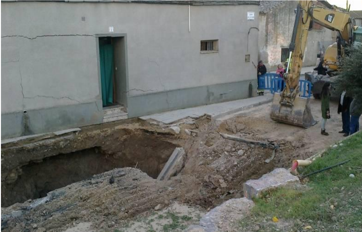
Foto 3. Sima en noviembre del año 2013. Con el paso de los años la magnitud del colapso ha ido aumentando, viéndose gravemente afectada la vivienda colindante. Autor: Sara Salas
