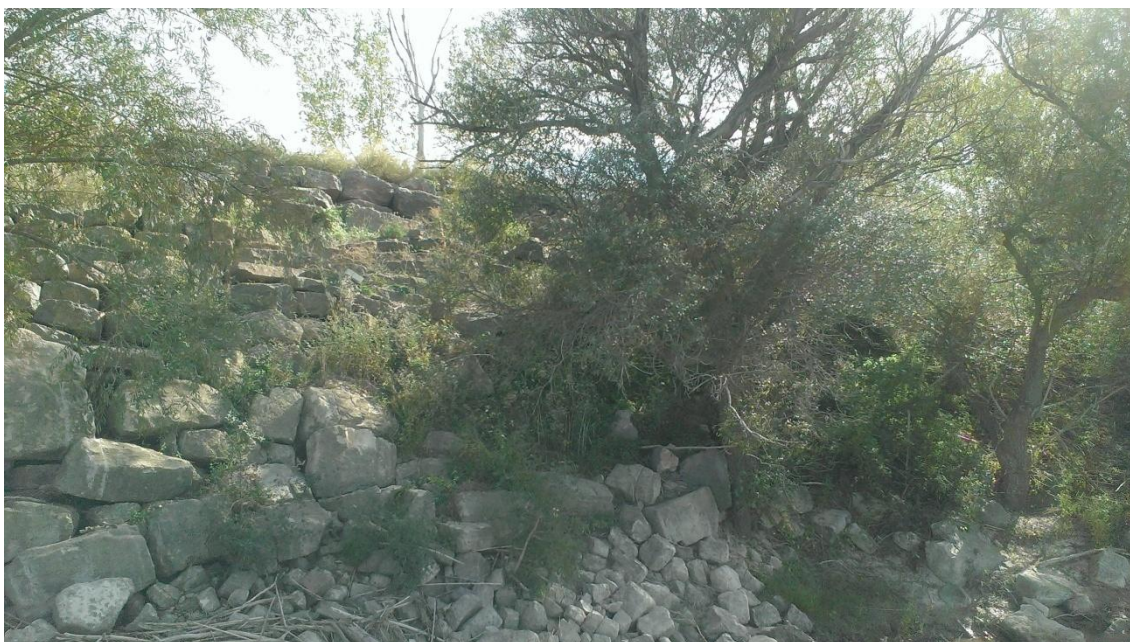
Foto 26. Detalle del estado de la escollera de Alcalá de Ebro. Autor: Sara Salas
