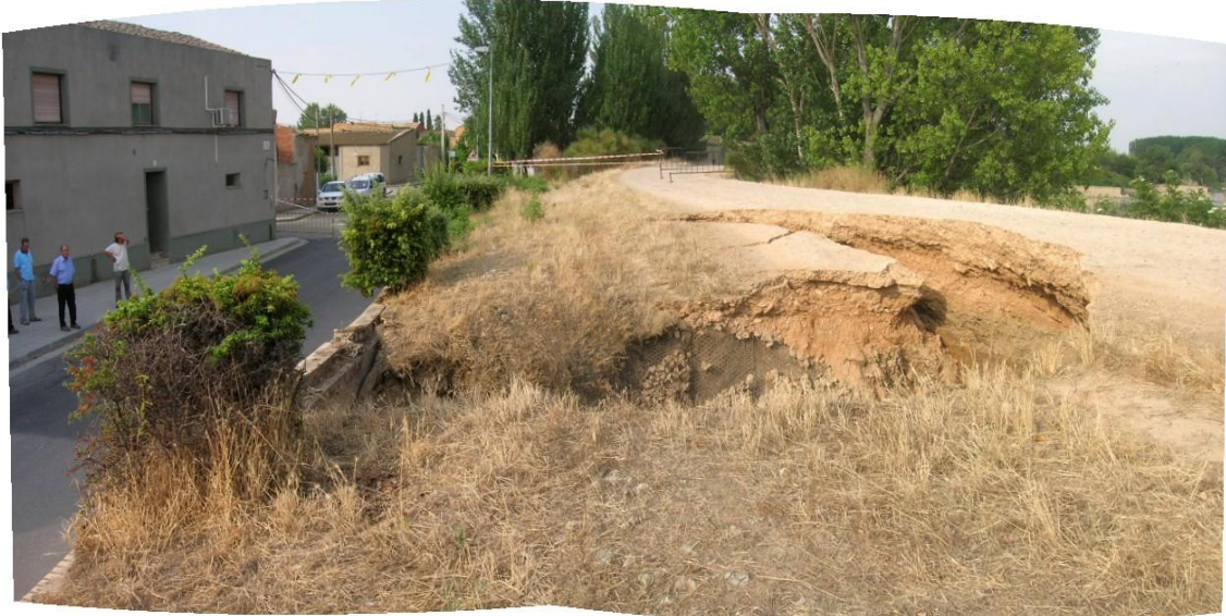
Foto 24. Mota afectada por la sima de Alcalá de Ebro (Febrero 2010). Autor: Periódico de Aragón
