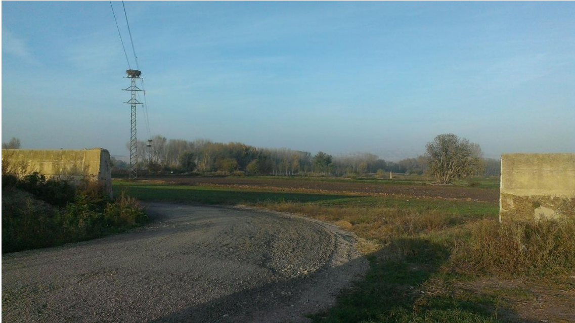
Foto 16. Estado actual del muro que rodea el casco urbano de Alcalá de Ebro. Autor: Sara Salas
