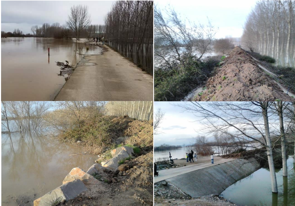
Foto 7-8-9 y 10. Estas imágenes pertenecen al mes de Marzo de 2015. El nivel del río supera el de la mota, y se reforzó su altura con tierra. En esta misma zona, se observa la transminación de agua, que tras la avenida permaneció varias semanas porque la defensa dificulta el retorno del agua al cauce. Autor: Susana Cuenca Casamián
