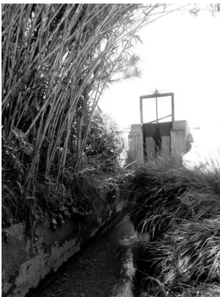
[Figura 11. Acequia afectada por el crecimiento de especies invasivas se observa su deficiente mantenimiento (Fuente: Panoramio)]
