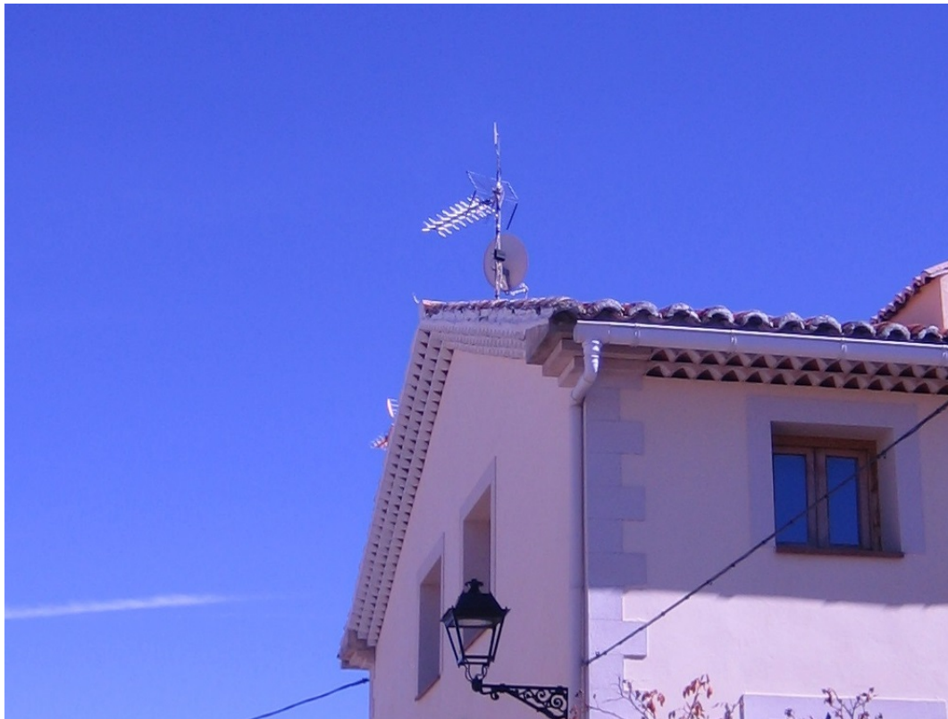
Figura 21: Antena PicoStation M en la Casa Particular.
