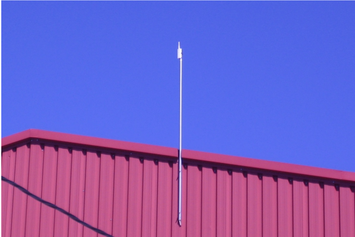
Figura 18: Antena PicoStation M instalada en el tejado del frontón de Alustante.
