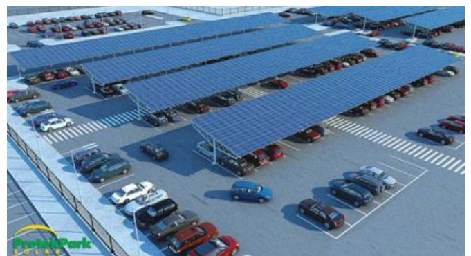
4_23 Placas solares colocadas en un aparcamiento.
