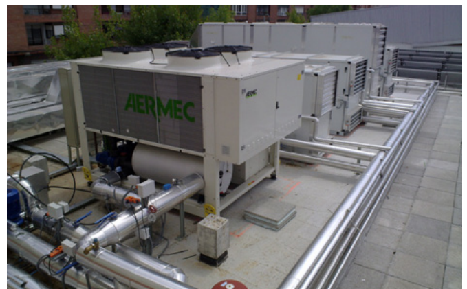
4_02 Maquinas de climatización.
